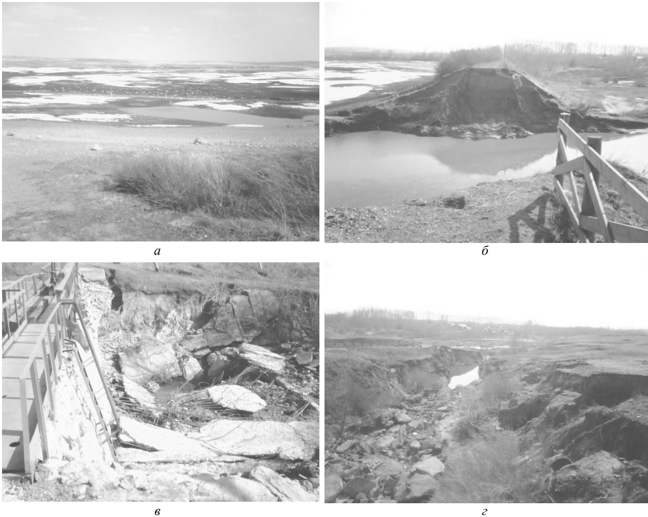
а — пустая котловина; б — створ, промытый потоком воды в теле плотины; в — шлюзовая камера; г — русло ниже водохранилища
